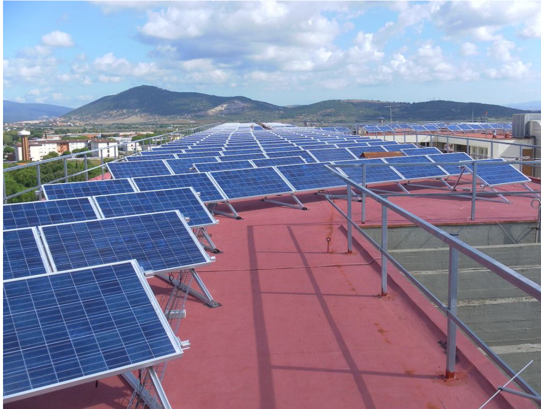
Presidio Ospedaliero “Misericordia” 67,5 kWp – Azienda USL 8 Grosseto
